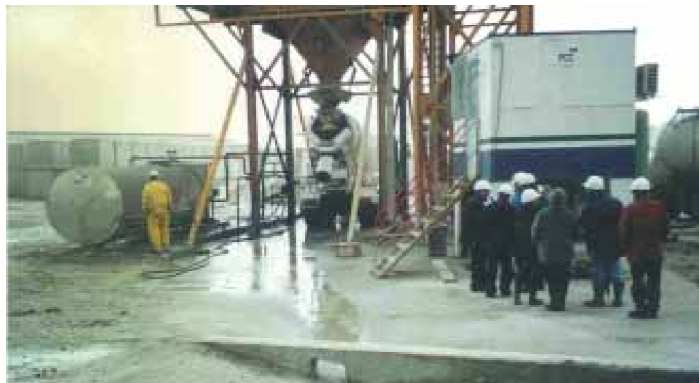
En las plantas de hormigón se instalan sistemas de recogida de las aguas de lavado que permiten su reutilización, evitando así el vertido de carga contaminante y ahorrando en el consumo de este recurso. (Planta montada para la construcción del Dique de La Osa, en Cantabria).
