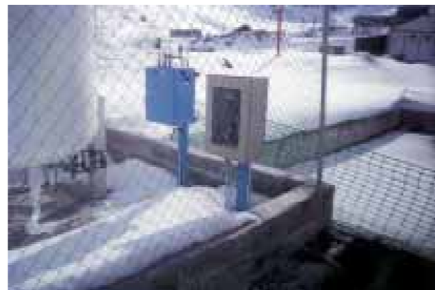
Detalle de gasificador del CO 2 y de medidor de pH en la depuración del efluente del Túnel de Envalira (Andorra).
