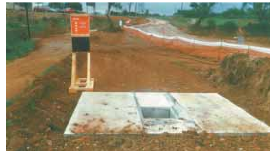
La creación de plataformas para el cambio de aceite evita una posible contaminación del suelo por hidrocarburos, en el caso de un vertido accidental (EDAR de Tarrasa).
