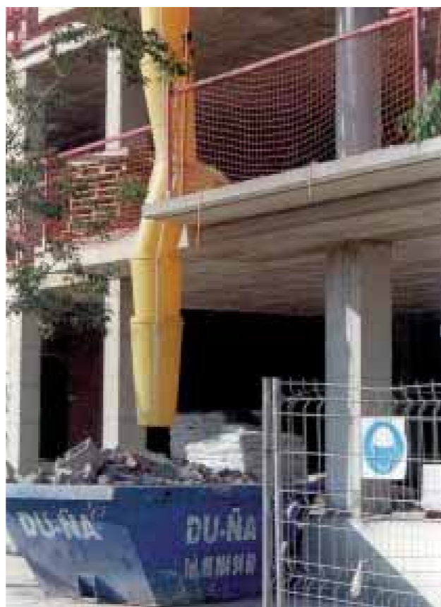
La Generación de ruido y polvo, las necesidades de espacio, son problemas que es preciso superar en la edificación.
