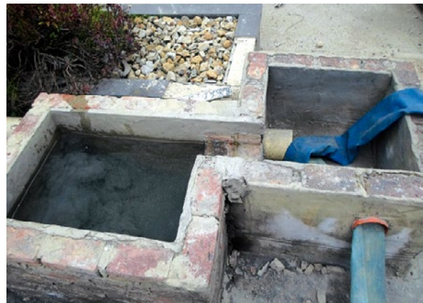
Incorporación del vertido a la red de alcantarillado
