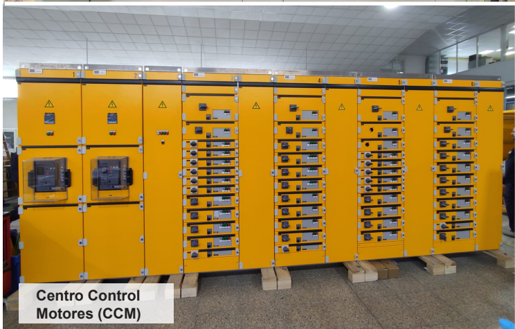
Taller de Cuadros Eléctricos propio
